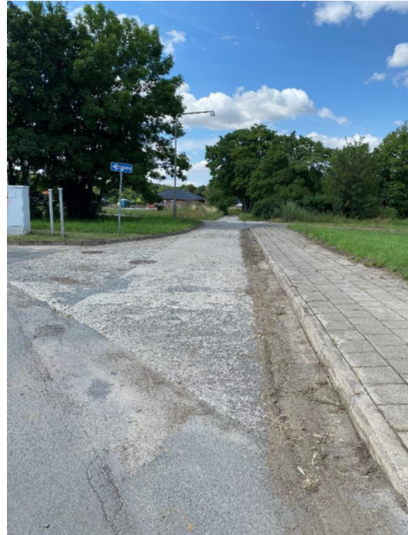
Abbildung 36: Sanierungsbedürftige Bäckerstraße mit einseitigem Fußweg
