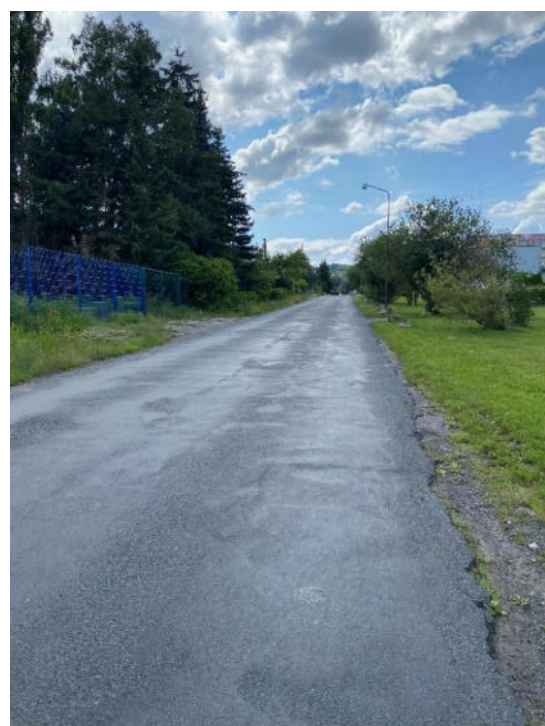
Abbildung 40: Fehlende Fußweg im ersten Abschnitt der Waldfriedenstraße
