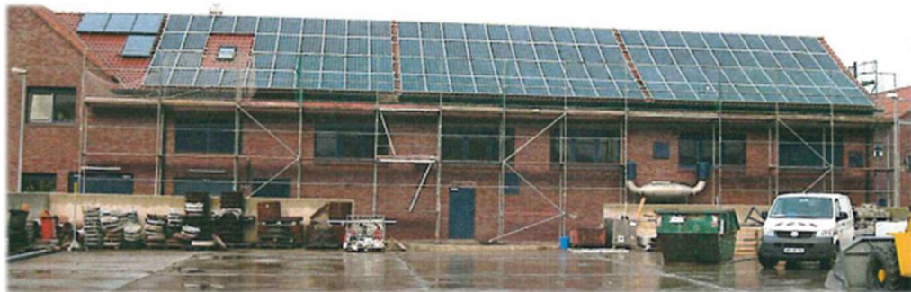
Abbildung 13: Photovoltaik-Anlage der TAZV 18
