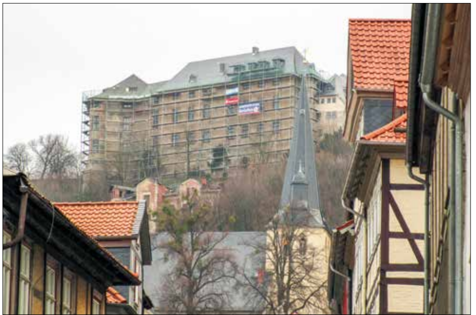
Das Dach des sogenannten Kirchenflügels am Blankenburger Schloss hat eine neue Eindeckung aus Schiefer erhalten.
