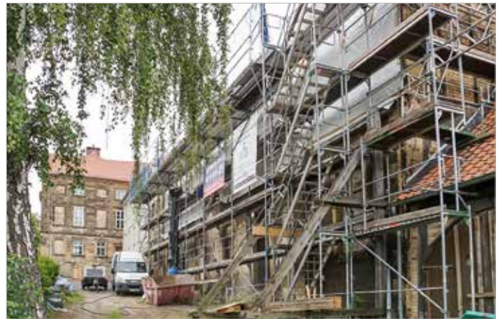
Derzeit finden am Kleinen Schloss umfangreiche Arbeiten statt, um die Bausubstanz in der ehemaligen Orangerie zu sichern.
